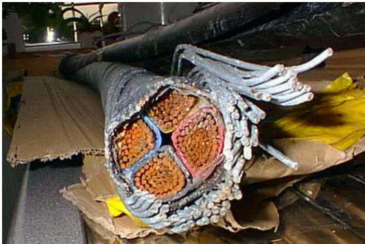
Şəkil 2.5. Kabelin mühafizə örtüyünün korroziyası
