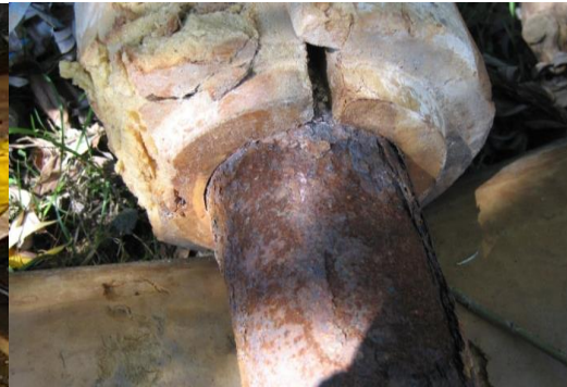
Şəkil 2.6. Kabelin cərəyandaşıyan metal borunun korroziyası
