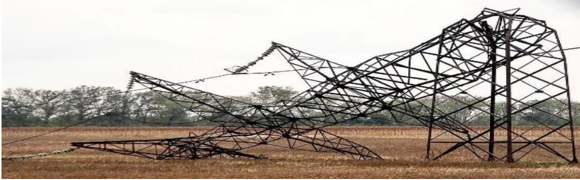
Şəkil 1.9. Elektrik dayağının sıradan çıxması
