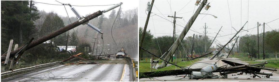
Şəkil 1.17. Tufan zamanı elektrik hava xətlərinin qırılması
