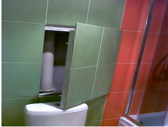
Şəkil 3.12. Gizli quraşdırılmış sistemlərə baxış
