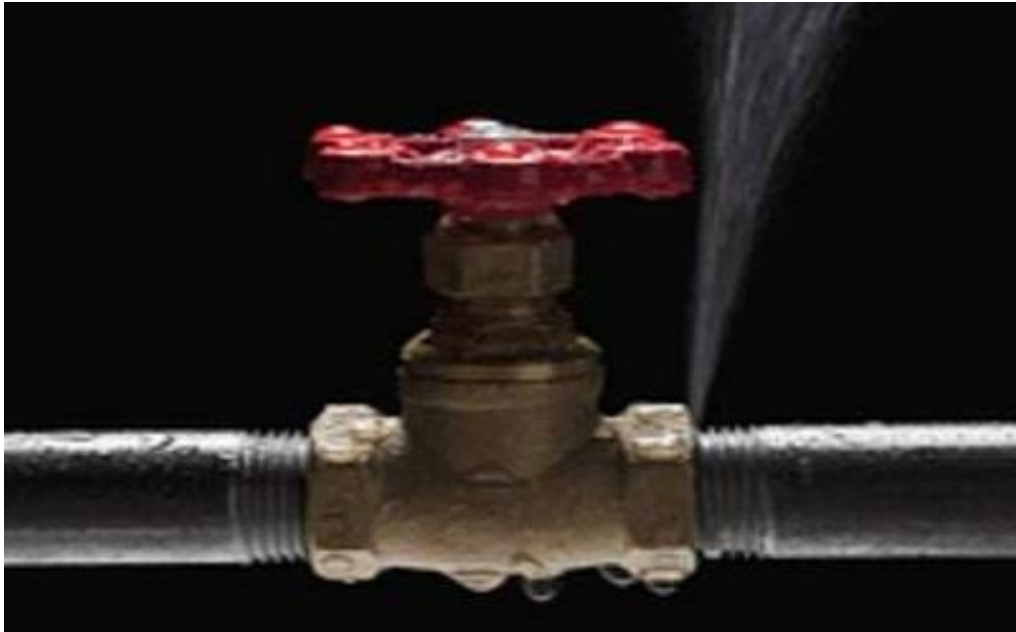
Şəkil 3.36. b) Su sistemində zədələnmələr
