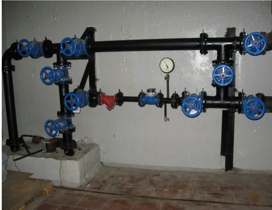
Şəkil 2.22. Pilləkən qəfəsində quraşdırılan suölçən qovşağ
