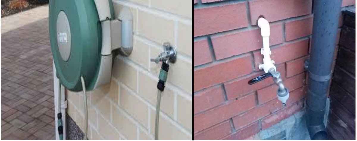
Şəkil 2.13. Bina fasadında quraşdırılmış sulama kranları
