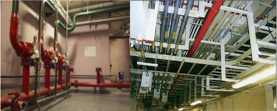
Şəkil 2.26. Yanğın əleyhinə su təchizatının boru kəmərləri
