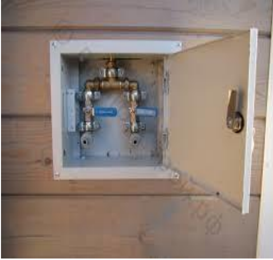
Şəkil 2.10. Sulama krani binanın fasadında
