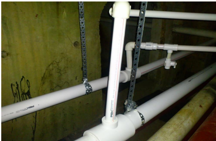
Şəkil 3.9. Polipropilen borulardan olan su xətləri
