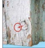
Şəkil 5. Ağac mıxla bəndlənmiş pəncərə
