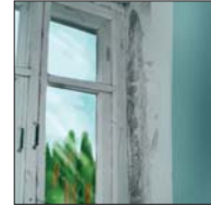
Şəkil 1. Köhnəlmiş pəncərə çərçivəsi
