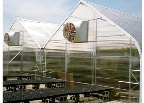
Şəkil 3.36. Məcburi ventilyasiya
