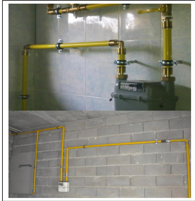
Şəkil 1.18. Binadaxili qaz boru xətti
