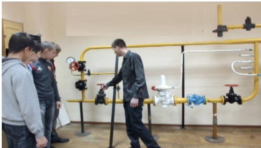
řakıl 2.16. Qaz boru k m rində qazın istismarı
