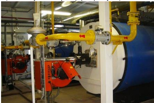
řakil 3.19. Suqızdırıcı qazanxana
