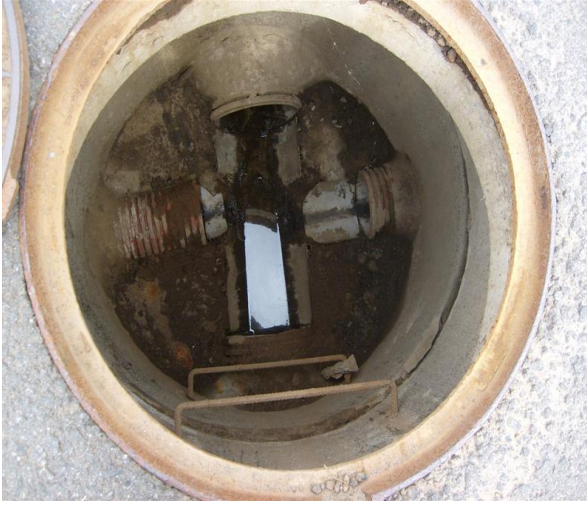
Şəkil 1.17. Dəmir beton baxış quyusu
