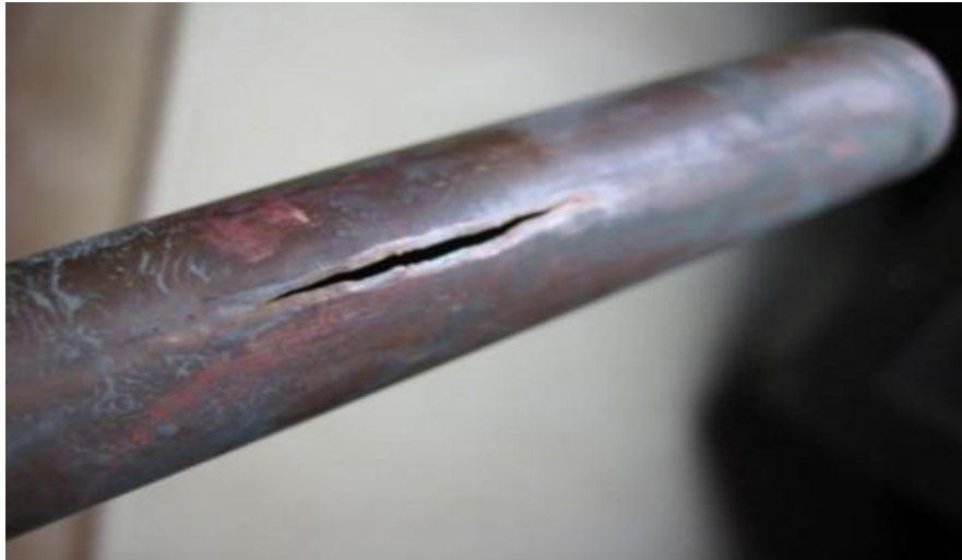
Şəkil 2.42. Boruda çatlar
