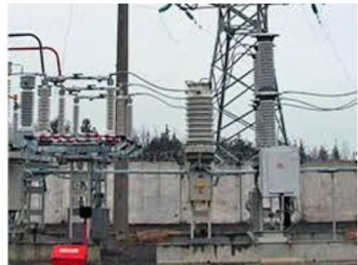
Şəkil 5.2. Qusar Elektrik şəbəkəsi
