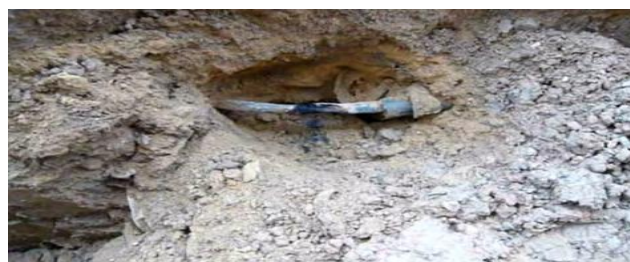
Şəkil 1.8. Gərginliyi 10 kv olan kabel xəttində nasazlığın təyin olunması
