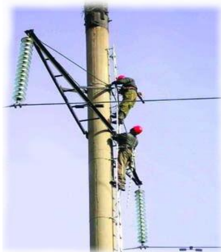
Şəkil 3.3. EVHX –nin sınağı
