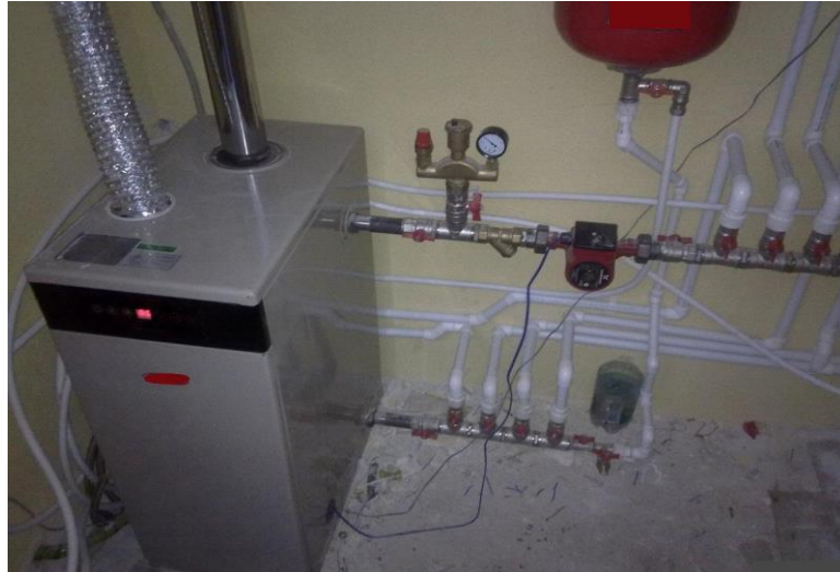
Şəkil 1.37. Maye yanacaqqla işləyən qazan
