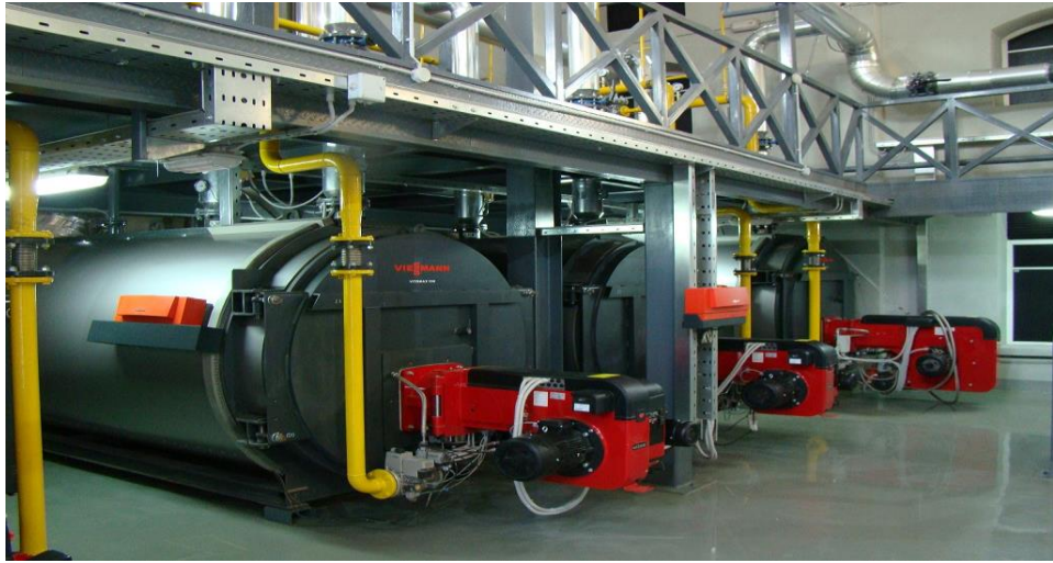
Şəkil 1.28. Qazanxananın ümumi görünüşü
