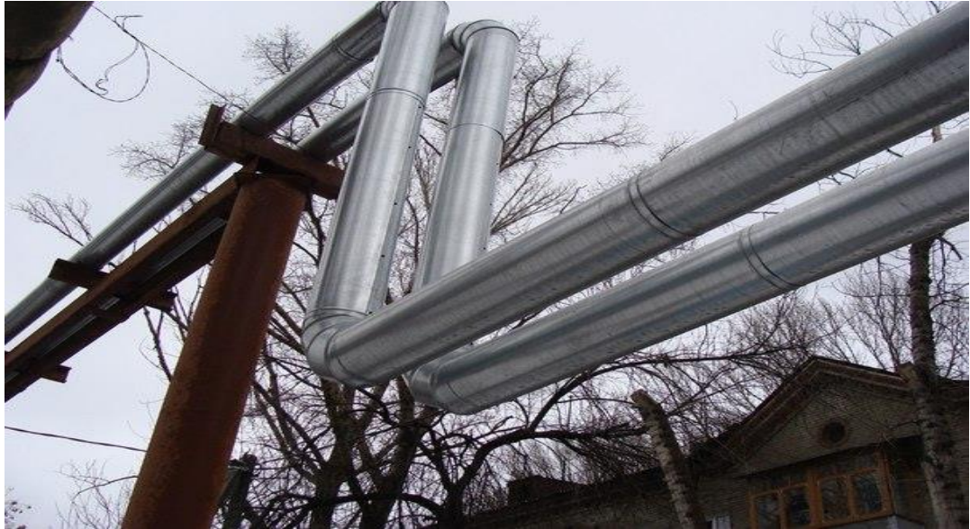
Şəkil 1.15. Yerüstü xarici istilik kəməri
