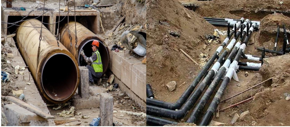
Şəkil 1.11. Xarici istilik xəttinin kanalla çəkilişi Şəkil 1.12. Xarici istilik xəttinin kanalsız çəkilişi
