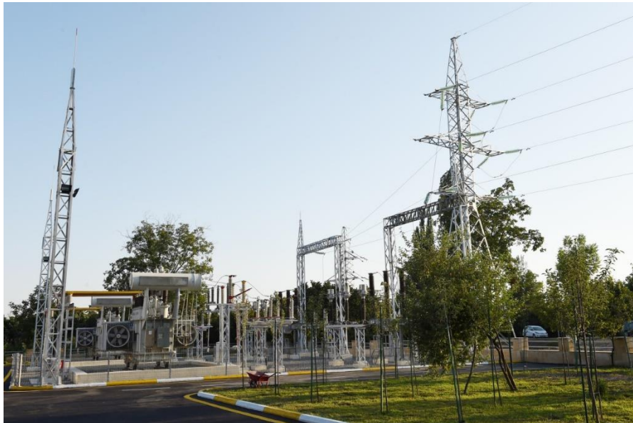
Şəkil 6.8. 110/35/10 kV-luq, 2x10 MVA gücündə yarımstansiya
