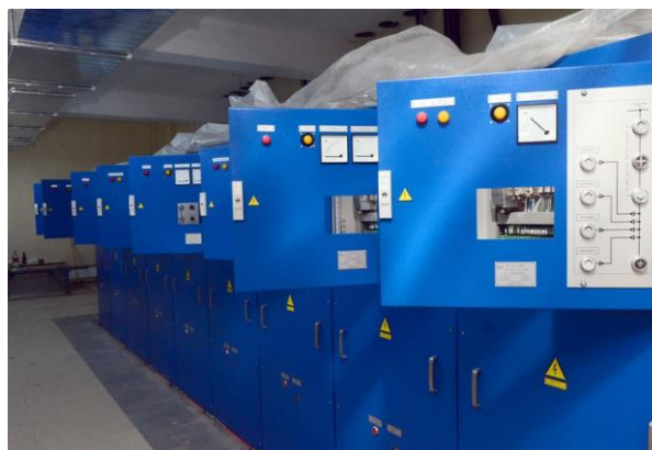
Şəkil 3.9 Elektrik yarım stansiya
