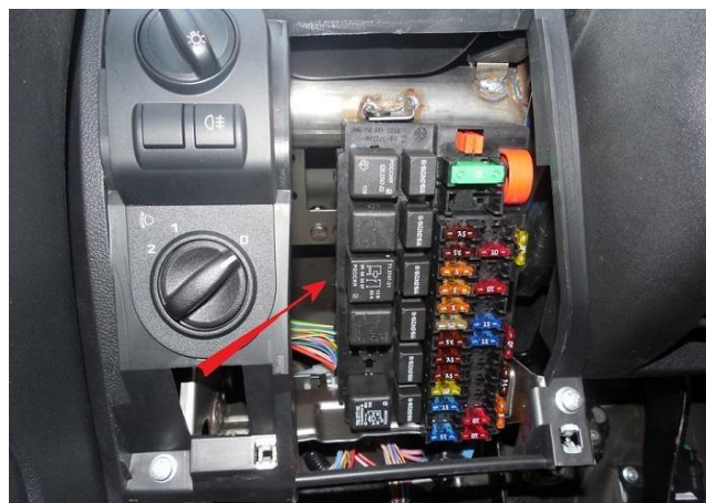
Şəkil 1.7 Elektrik cərəyan ötürücüsü
